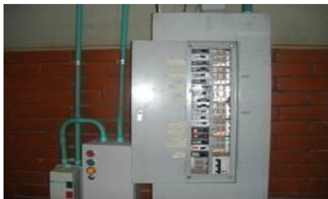
Ilustración 5 Tablero eléctrico SDP- CAD
