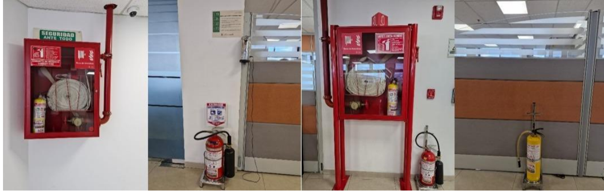
Ilustración 9 Dispositivos Contra Incendio
